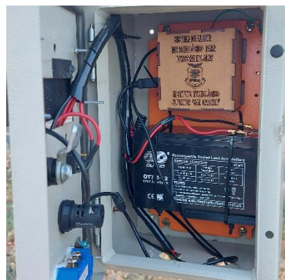
Figura 6: Gaveta de equipos SAOS.
